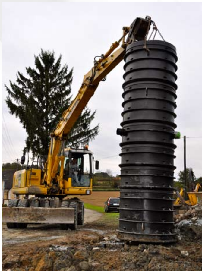
Schacht DN 1250, Höhe 4,50 Meter
